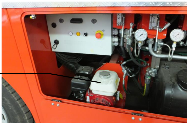
Фотография № 2 Аварийный насос, поз.15 на гидросхеме. .
