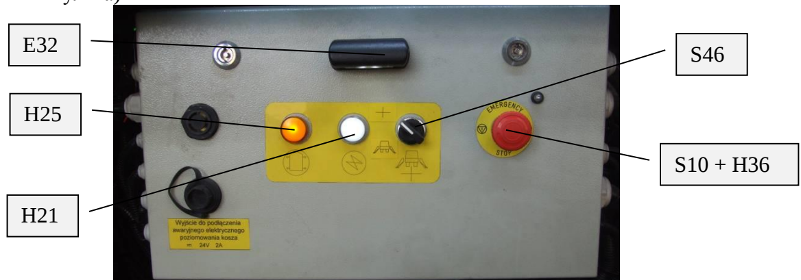
Фотография № 15 Пульт аварийного управления опорами.
